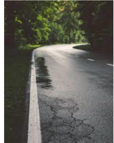
Figure 2 Chaussée présentant plusieurs dégradations
